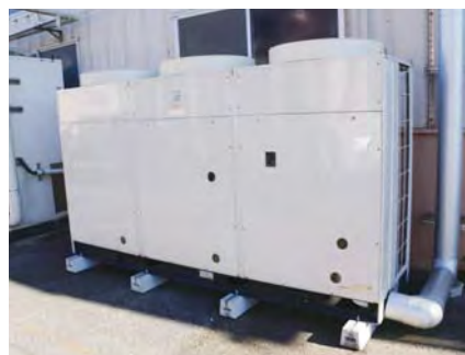
今回導入したトンネルフリーザー用の冷蔵機
