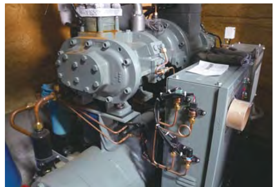
新しい冷凍機により冷凍時間が大幅に短縮された
