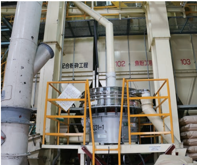
微粉碎したペレット用生地を大型円筒フルイに通し、粒子の大きさを揃えることで、小口径ペレット製造が可能になった
