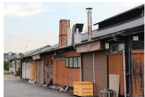
東日本大震災で折れてしまった煙突
