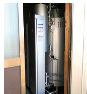
釜茹で用ボイラー
