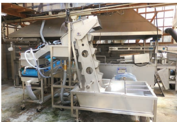
原料選別投入コンベア
