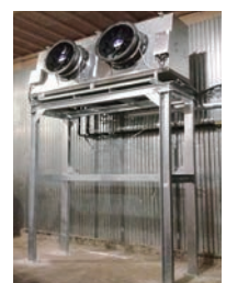
冷却器、冷却器架台
